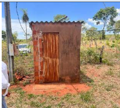
Abrigo do quadro de comando.
