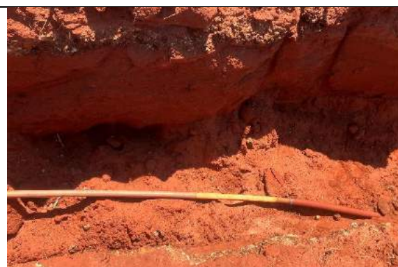
Detalhe da rede de distribuição
